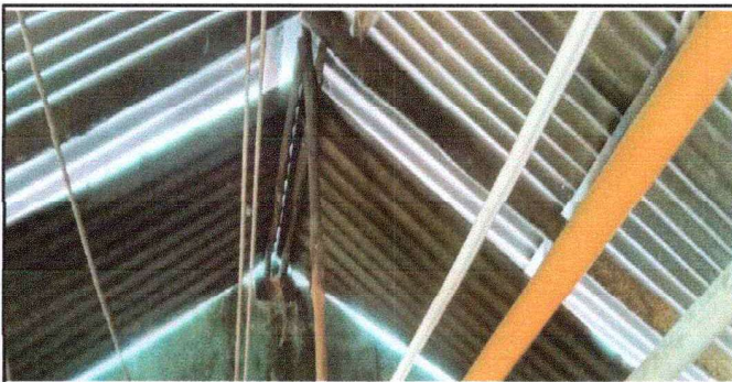
Foto 11: estado actual de techo cocina.
