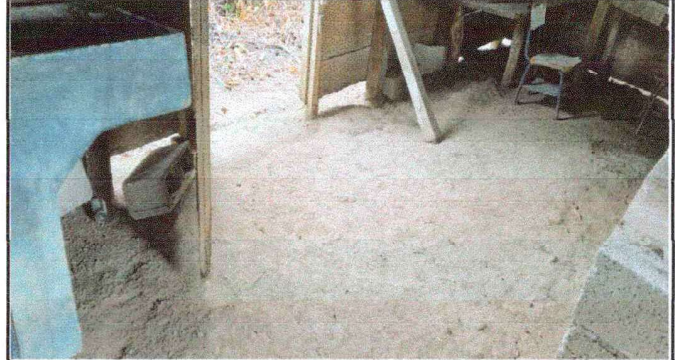
Foto 8: Estado Actual piso de la cocina.
